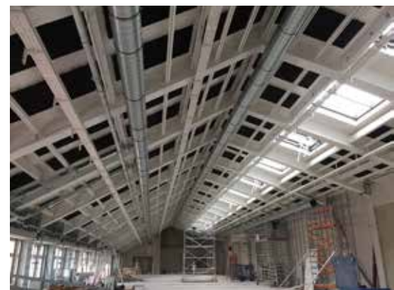
Installationen im dritten Obergeschoss.
